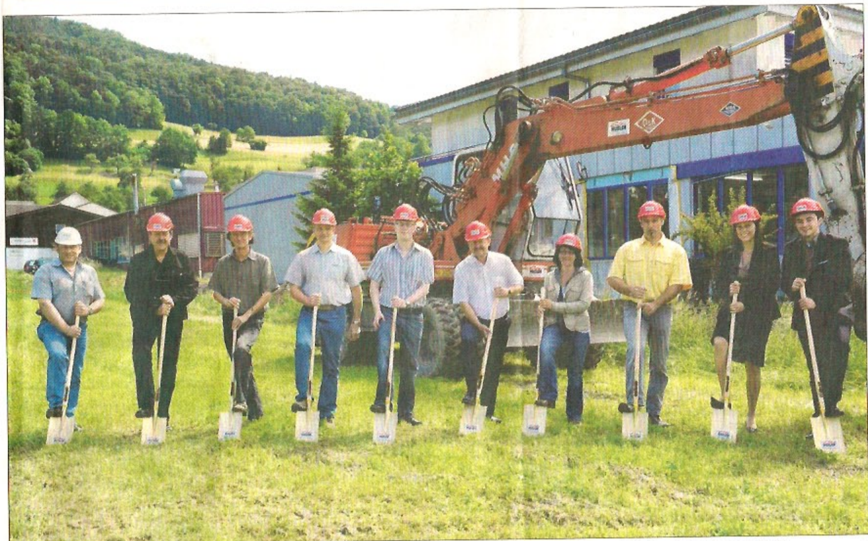
Spatenstich in Leimbach: Die Rofam GmbH baut nordwestlich des bestehenden Produktionsgebäudes eine neue, rund 380 Quadratmeter grosse Halle.
