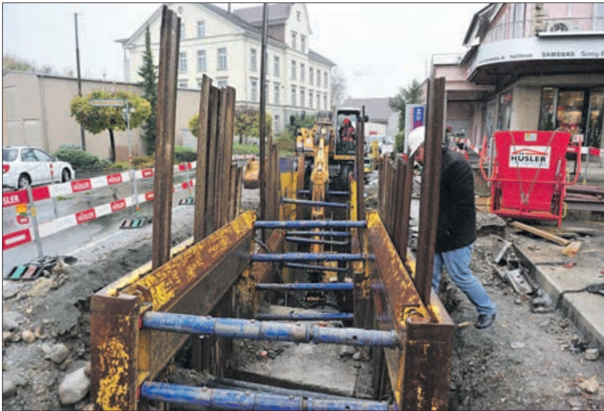
Aufwändige Tiefbauarbeiten Oberdorf Reinach: Bis Ende Jahr soll die Baustelle geräumt sein und der Verkehr auf der Hauptstrasse wieder in beiden Richtungen rollen. (Bild: msu.)
