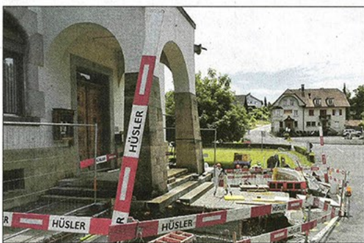
Feuchtigkeit und der Zahn der Zeit: Der Balkon im Obergeschoss und die
