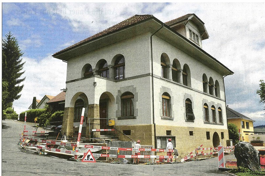
Baustelle Schul- und Gemeindehaus Birwil: Die Sanierung des Gebäudes und die Neugestaltung der Umgebung sind angelaufen.
