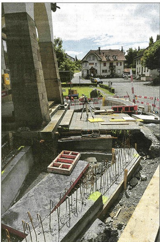
Neu mit Entwässerungssystem: Die neuen Rabatten im Eingangsbereich sind teilweise bereits erstellt.
