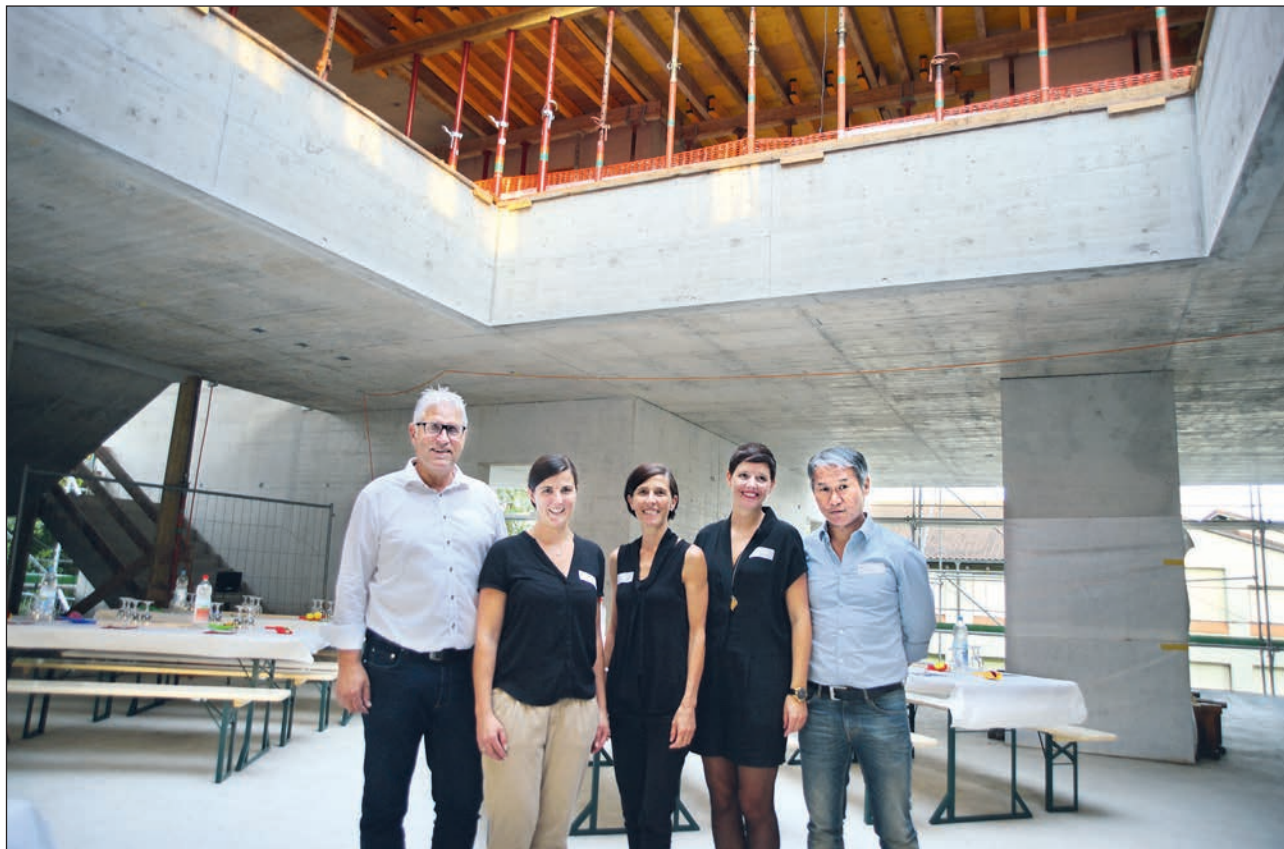
Stehen im «Herz» des neuen Schulhauses: vl: Hanspeter Lang, Gemeinderat und Baukommissionspräsident; Cäcilia Bucher, Bauleiterin; Susanne Grosse-Furrer, Gemeinderätin und Vizepräsidentin der Baukommission und die beiden Architekten Manuela Studer und Dorji Tashi. (Bild: Sandro Portmann)
