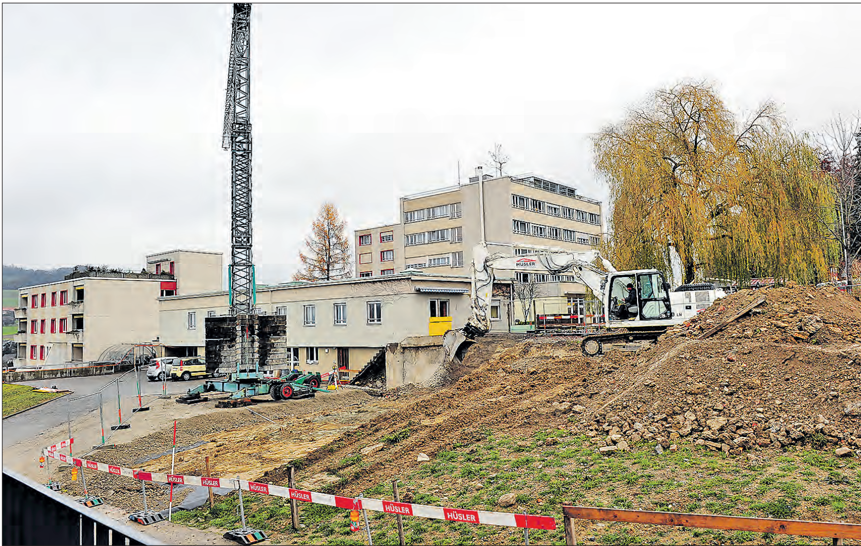
Baustart beim Altersheim Sonnenberg in Reinach: In einer ersten Phase wird der Schützenweg ausgebaut. Später folgen ein neues Bettenhaus mit Tiefgarage und der Umbau des bestehenden Altersheims (Hintergrund) in Alterswohnungen. (Bild: msu.)
